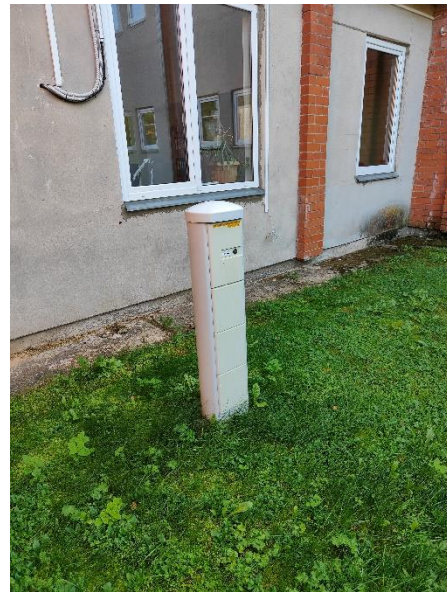
2.6. Ārtelpu (āra) optisko šķiedru kabeļu sadales skapis (SIS tipa)
