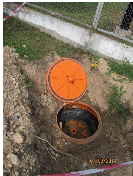
2.4. Pazemes kamera ar optisko šķiedru kabeļu rezerves cilpu (būvniecības procesā)
